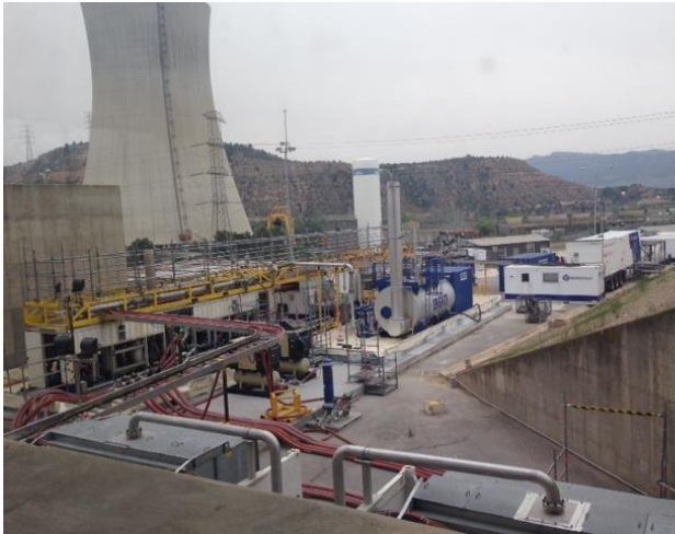
Planta de tratamiento para la limpieza química de los generadores de vapor.
